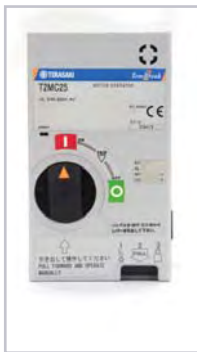
Interruptor en posición ON
