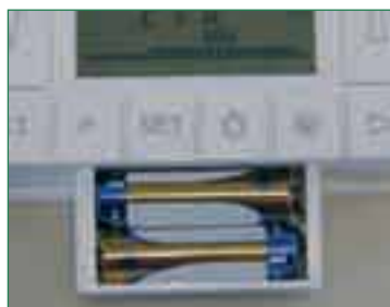
Cajetín de las pilas.
