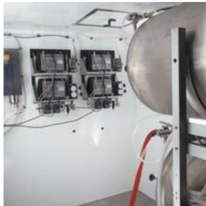
Compresores para la dispensación de bebidas
