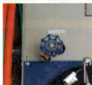
> Grifo de agua auxiliar
