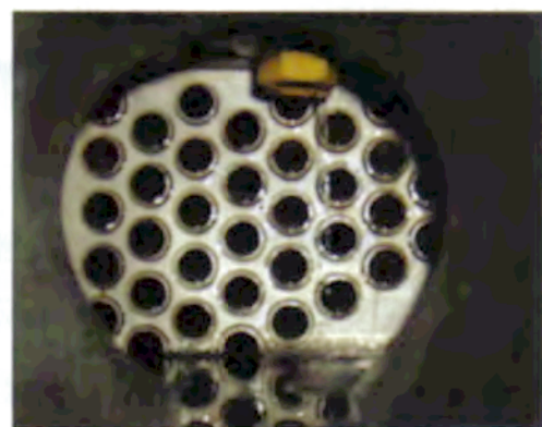
> Intercambiador de calor después de usar ScaleBreak.
