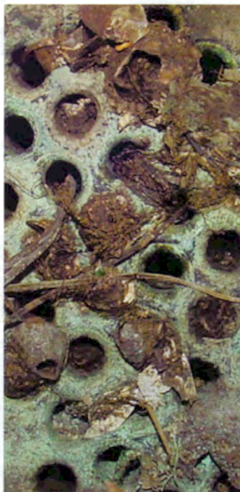
> Enfriador antes de usar ScaleBreak.
